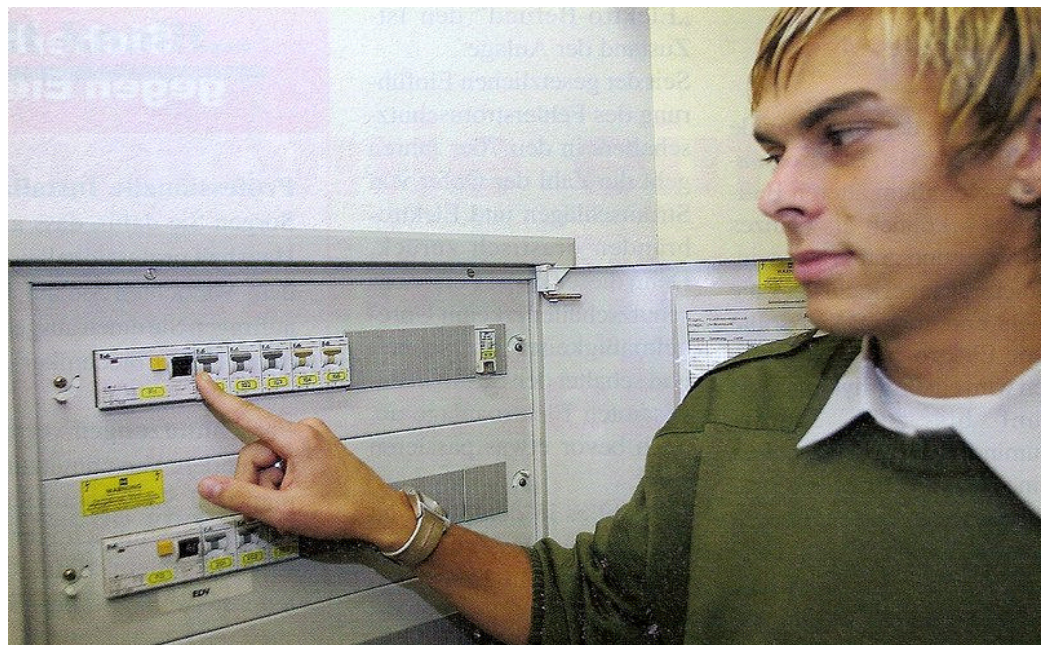
Der FI-Schalter hat eine lebensrettende Funktion, welche immer wieder geprüft werden soll
